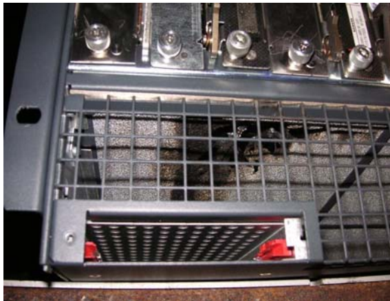
Pic. 20 : Fan Filter
